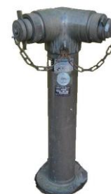
消防隊専用 屋外連結送水口 (消火栓) 棟の入口にある
