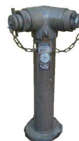
消防隊専用 屋外連結送水口 (消火栓) 棟の入口にある
