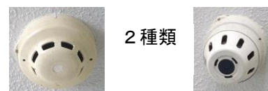
火災熱感知器 各階1号室・4号室前天井 1階エントランス天井 駐輪場天井
